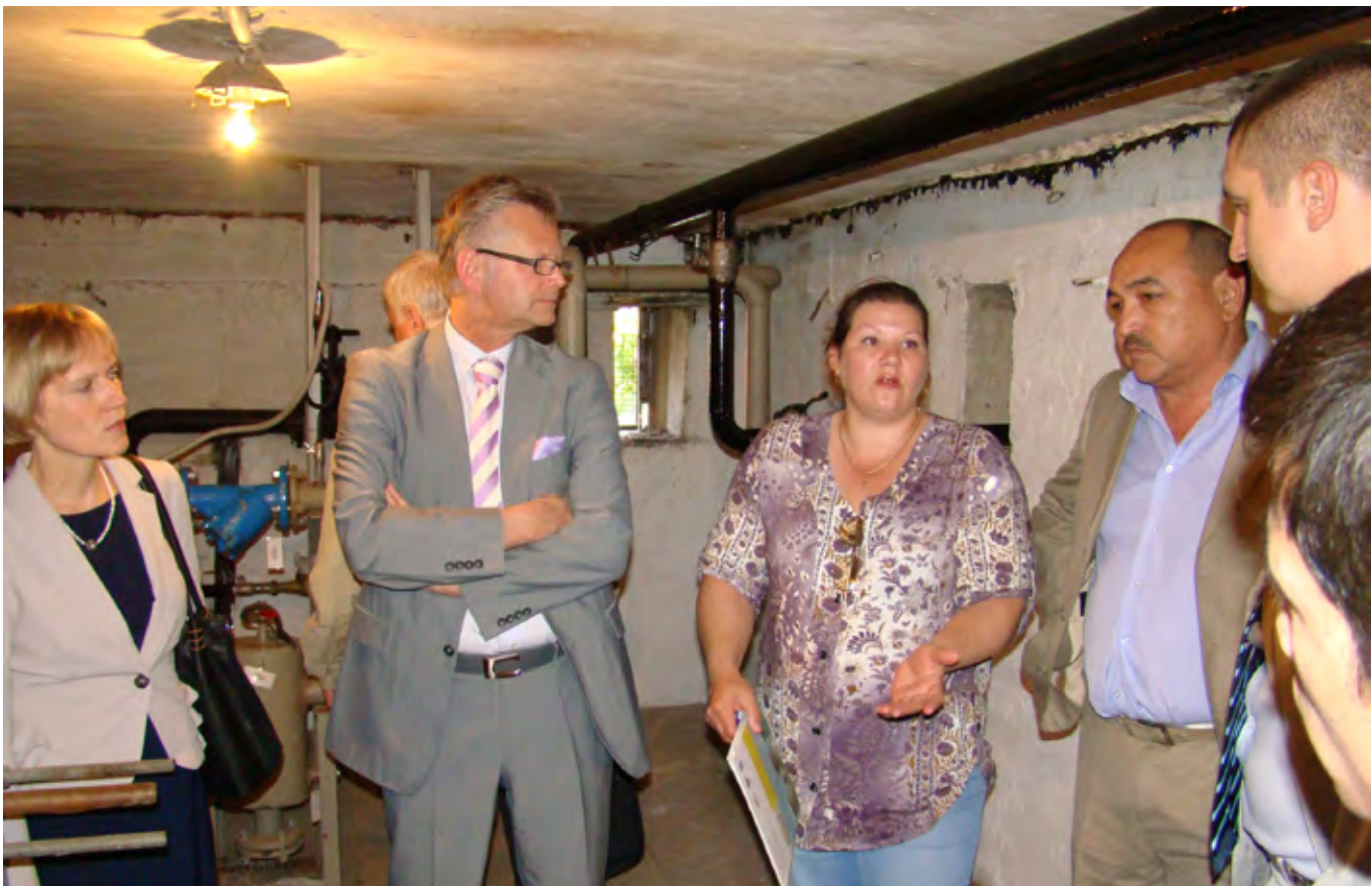
OBEW Begutachtung eines der UNDP-Pilotobjekte: Larissa Schreckenbach, IWO e.V., Gutacher Ralf Hillenberg, IPB.B Ingenieurbüro für Projektentwicklung und Baubetreuung GmbH, sowie KSK-Vertreter diskutieren mögliche Sanierungsmaßnahmen. © Marat Issabekow
